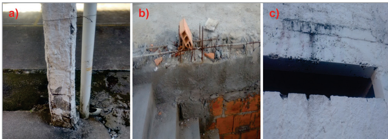
Figura 4. a) Armadura exposta devido à falhas na concretagem b) ninho de concretagem na laje do reservatório e c) ninho de concretagem na viga do banheiro feminino
