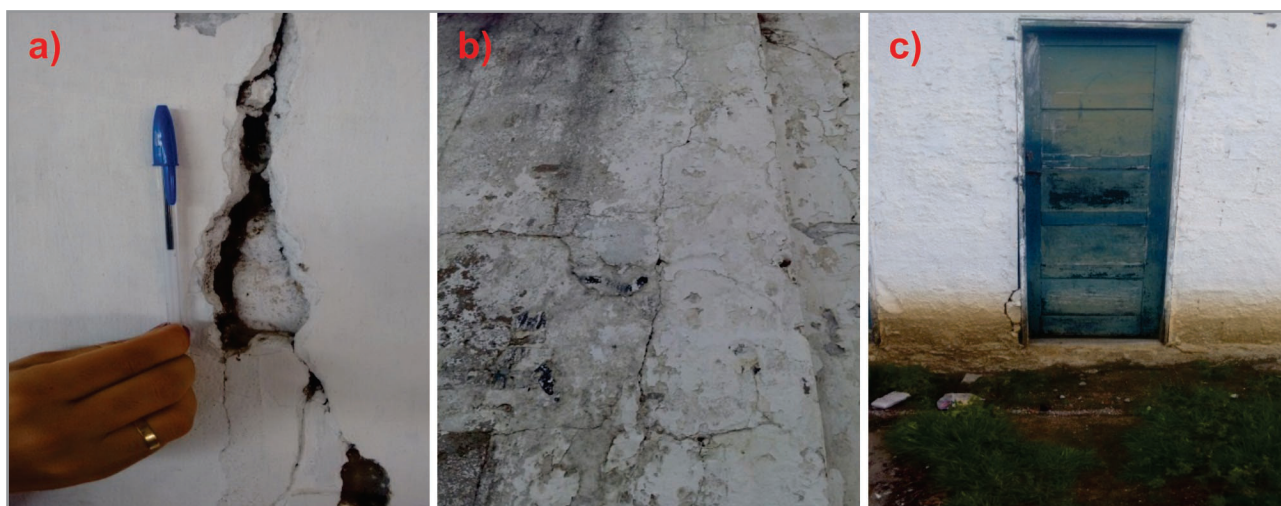
Figura 5. Exemplos de trincas, fissuras e rachaduras encontradas na edificação. a) Rachadura, b) fissura mapeada c) envoltória da porta de madeira com fissuras evidentes
