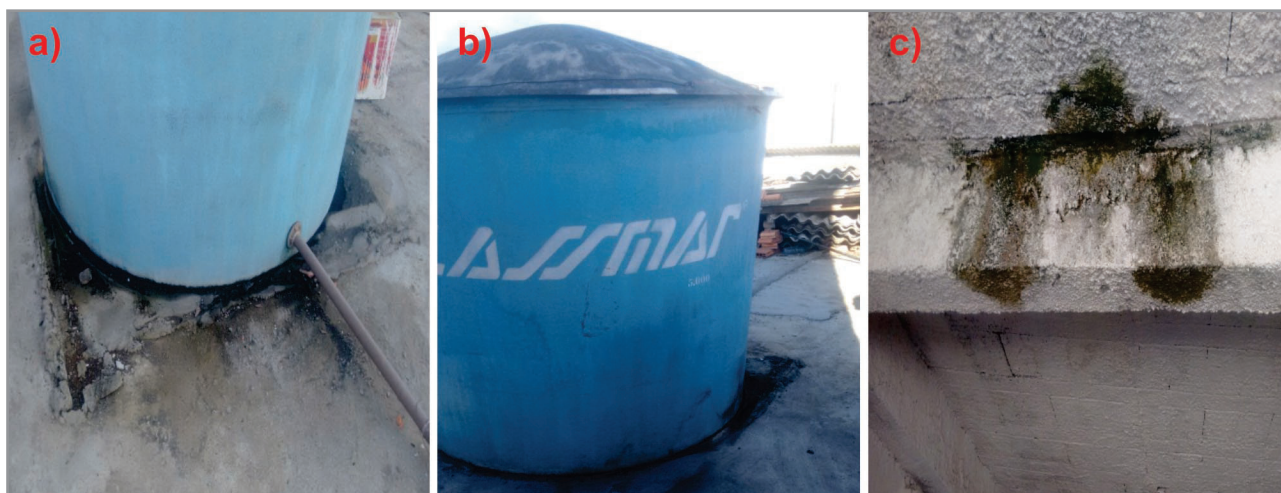
Figura 3. a) Vazamento no cano que recolhe água do reservatório superior, b) falhas graves na impermeabilização da laje que recebe o reservatório e c) manchas provocadas pela umidade na estrutura sob o reservatório
